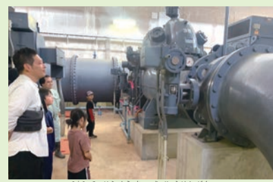
南美原揚水機場見学
